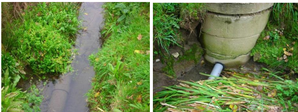
Photo 2 : Canalisation qui permet l'écoulement gravitaire des eaux usées vers le poste de refoulement de Bertheaume (à gauche) et regard avec branchement en bordure de ruisseau (droite)
