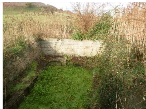
Photo 6 : Lavoir captant une zone d'émergence de nappe et réceptacle d'une canalisation dont la fonction est inconnue (drain, pluvial...)
