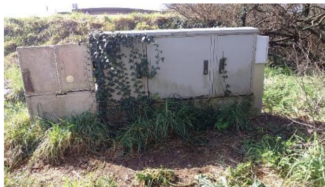
Photo 2 : Poste de relevage de Portez
