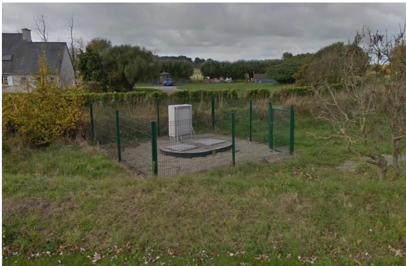
Figure 7 : Poste de relèvement de la route de la plage à Lampaul-Ploudalmézeau
